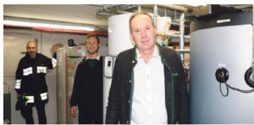
Kommandant Georg Rumppler, Jakob Fröhling und Bürgermeister Franz Rumppler bei der neuen Heizung im Feuerwehrhaus St. Veit.
