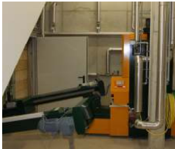
Abbildung 65: Heizkessel mit Förderschnecke, Kindergarten St. Johann Köppling, MR 2010
